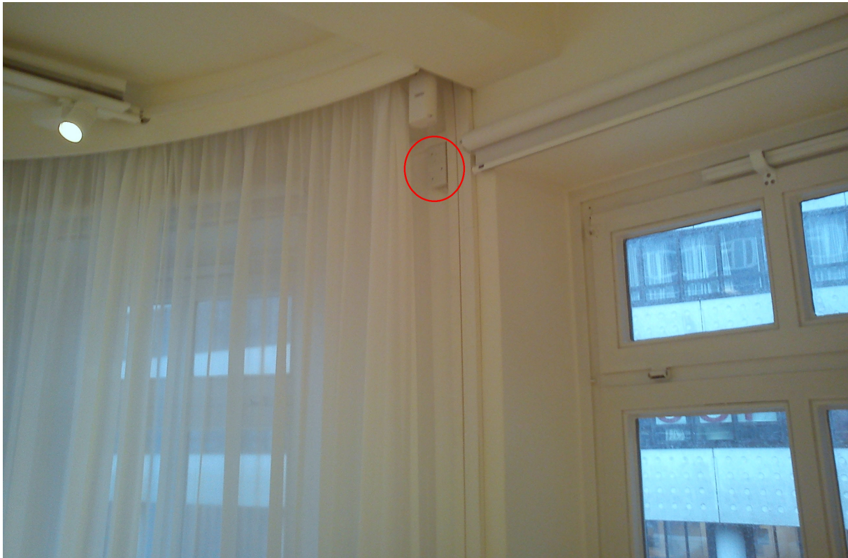
Abbildung 9.4.: In der Wohnung montierter Sensorknoten
