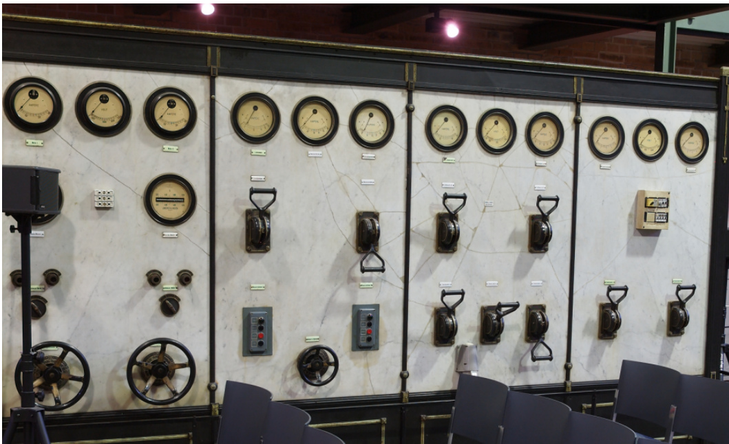
Abbildung 2.1: : Fotoausschnitt einer Schalttafel [Quelle: Schalttafel]
